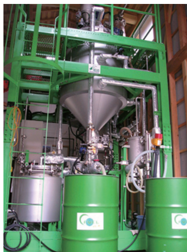
燃料製造装置
