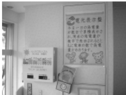
玄関に設置された発電量表示盤
