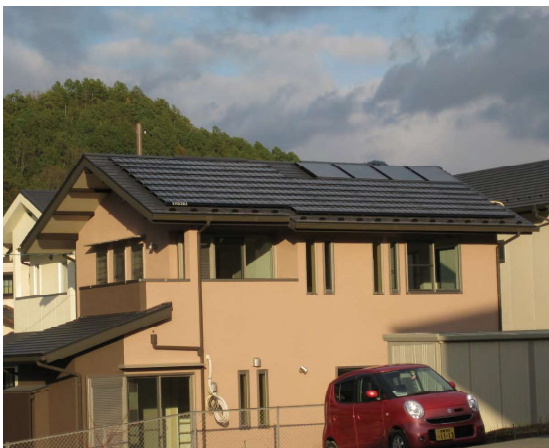
屋根上に設置された太陽光発電パネルと太陽熱温水器の集熱板
