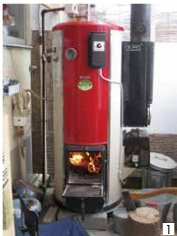
1) 薪ボイラー 2) 薪を燃やしているところ 3) 太陽熱温水器
