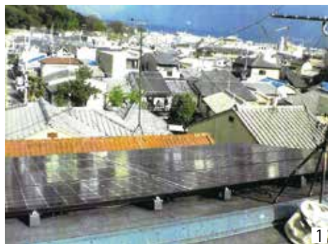
1) 設置している太陽光パネル 2) 買電メーターと売電メーター
